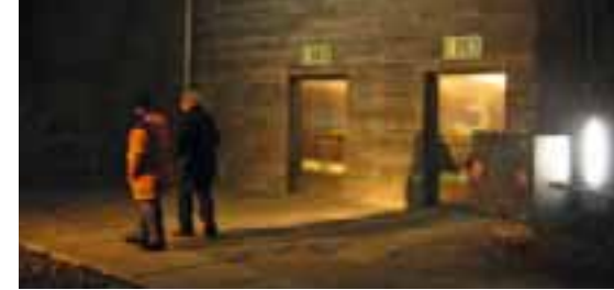
Färdiga brandslussar i Åsatunneln, utanför Göteborg.
